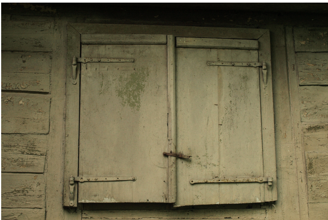
Pils_5_62010220090003_slegi1 Sākotnēji (19.gs.3.cet.) slēgi ar oriģinālo aprīkojumu. Slēgi apzāģēti, apmales – 20.gs.2.puse.
