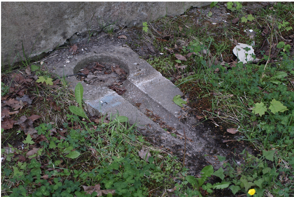
Pils_1_62010220088001_detala1 Vēsturiska betona lietusūdens noteka.
