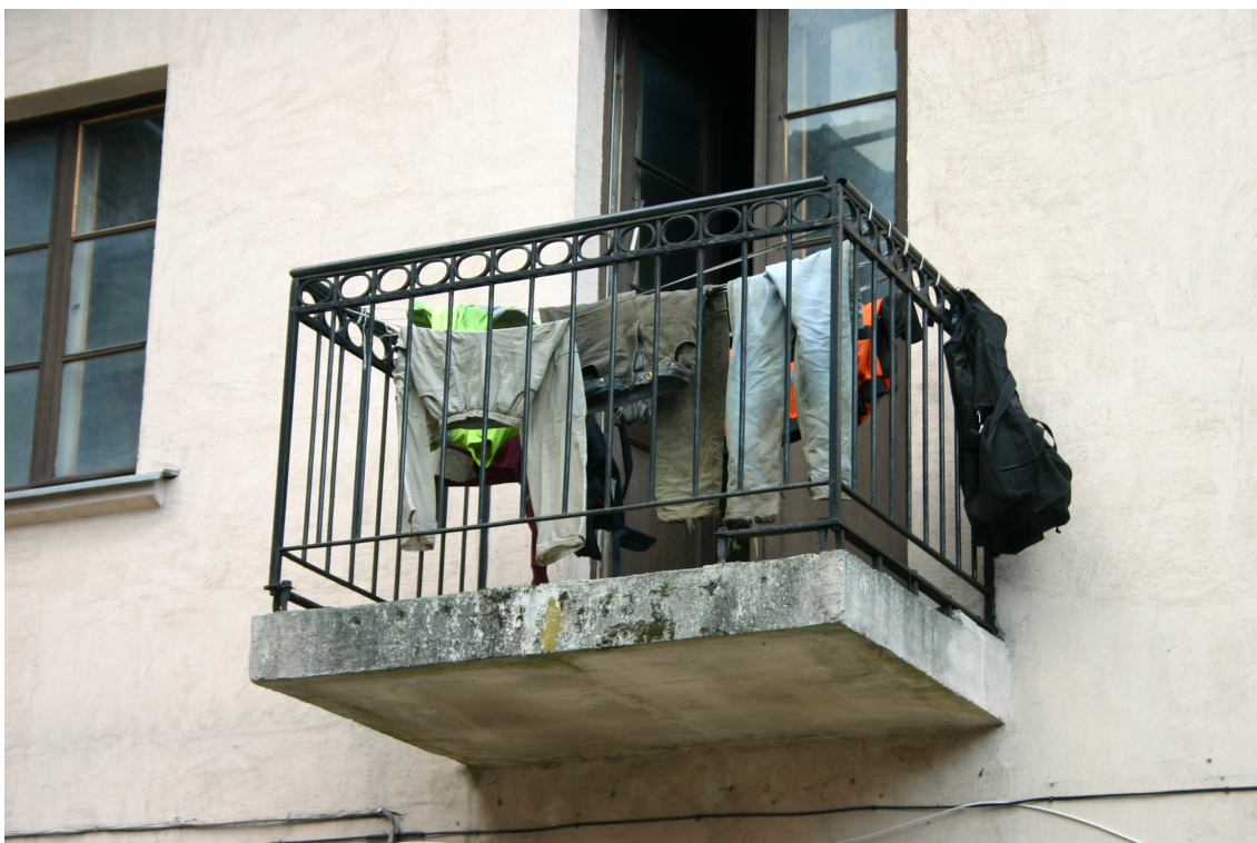
Liepaažas_8_62010230035001_balkons1 Sāktņējas (1913.g.) balkona margas. Balkona pamatne, domājams, pārbetonēta.
