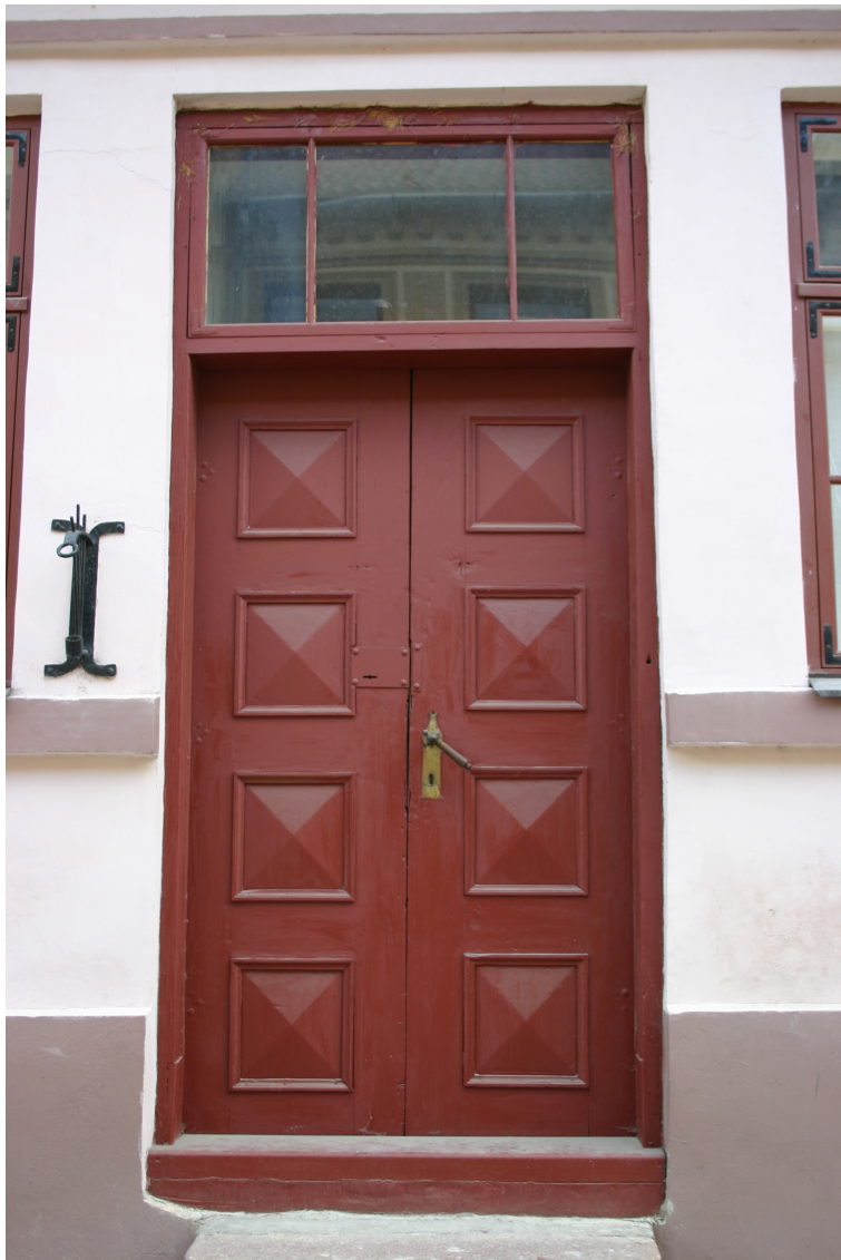
Liepaajas_6_62010230002004_durvis1 Sākotnējs (19.gs.vidus) durvju komplekts ar oriģinālo aprīkojumu. Virslagam zuduši spraišļi.
