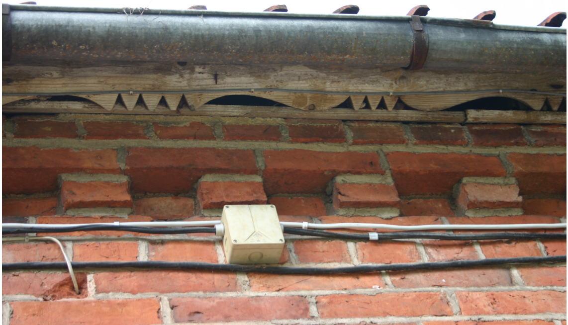
Liepaajas_4_62010230002001_dzega1 Sākotnēja (19.gs.beigu) ķieģeļu dzega un vēsturisks kokā griezts aizsegdēlis.
