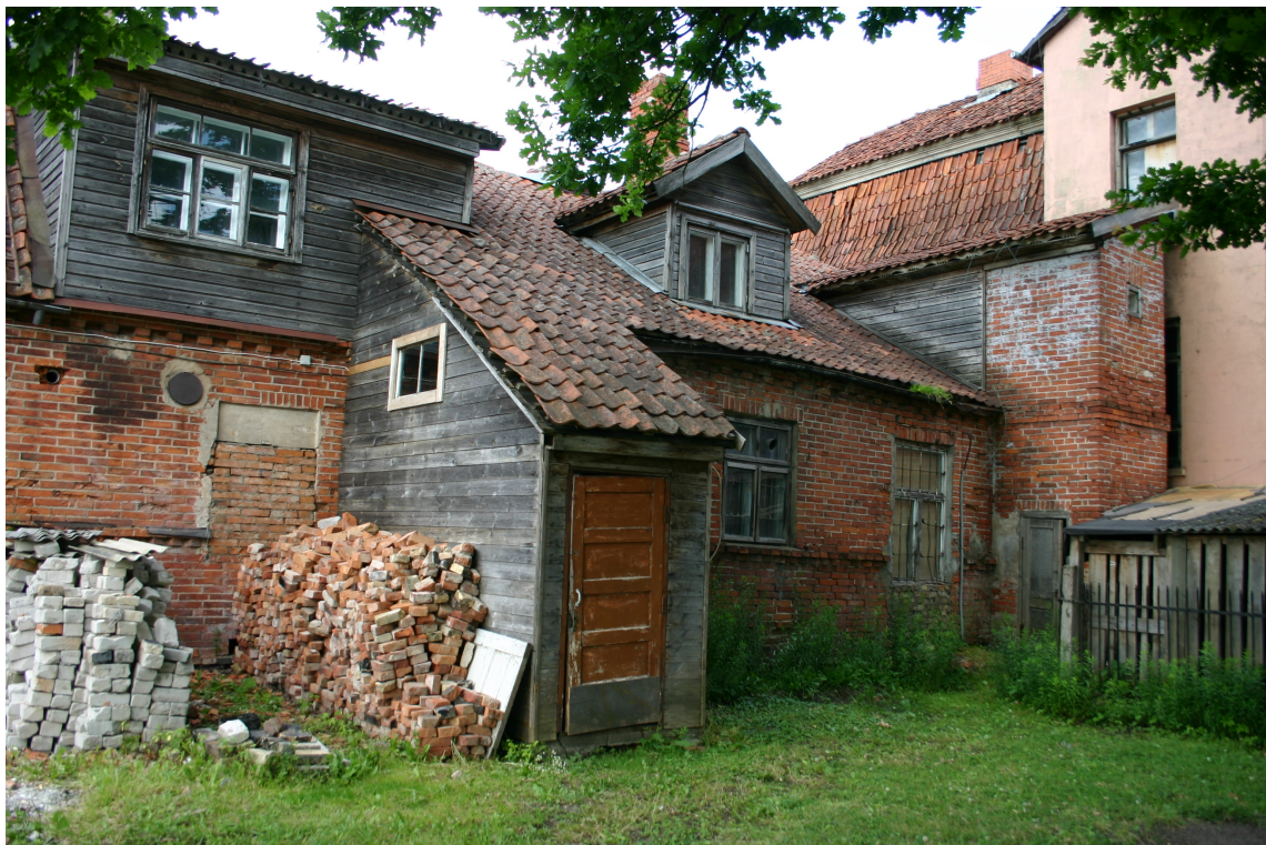
Liepaajas_4_62010230002001_fragments1 Dienvidu fasādes fragments. Labajā pusē esošā jumta izbūve vēsturiska, kreisajā – 20.gs.2.puse. Priekšplānā esošā koka piebūve – 20.gs.2.puse.
