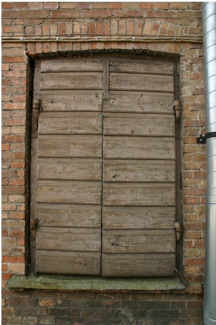
Liepaajas_1_62010060038001_slegi1 19.gs.2.puses slēgi ar oriģinālo aprīkojumu.
