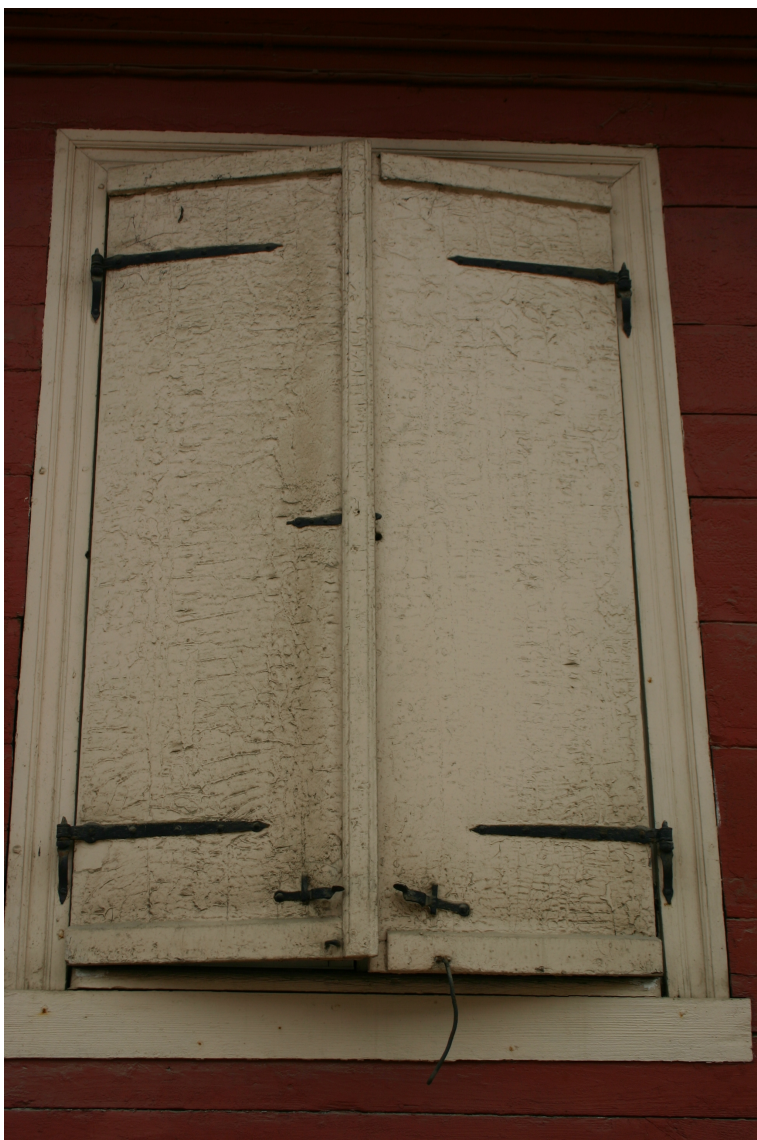
Liepaajas_17_62010090092001_slegi1 Vēsturiski slēgi ar oriģinālo aprīkojumu.
