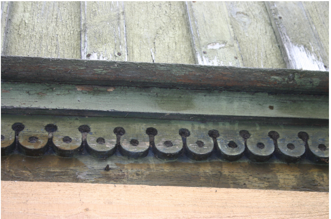
Kalna_18_62010220035001_detala1 19.gs.beigu kokā griezts dekoratīvs dēlis austrumu fasādē.
