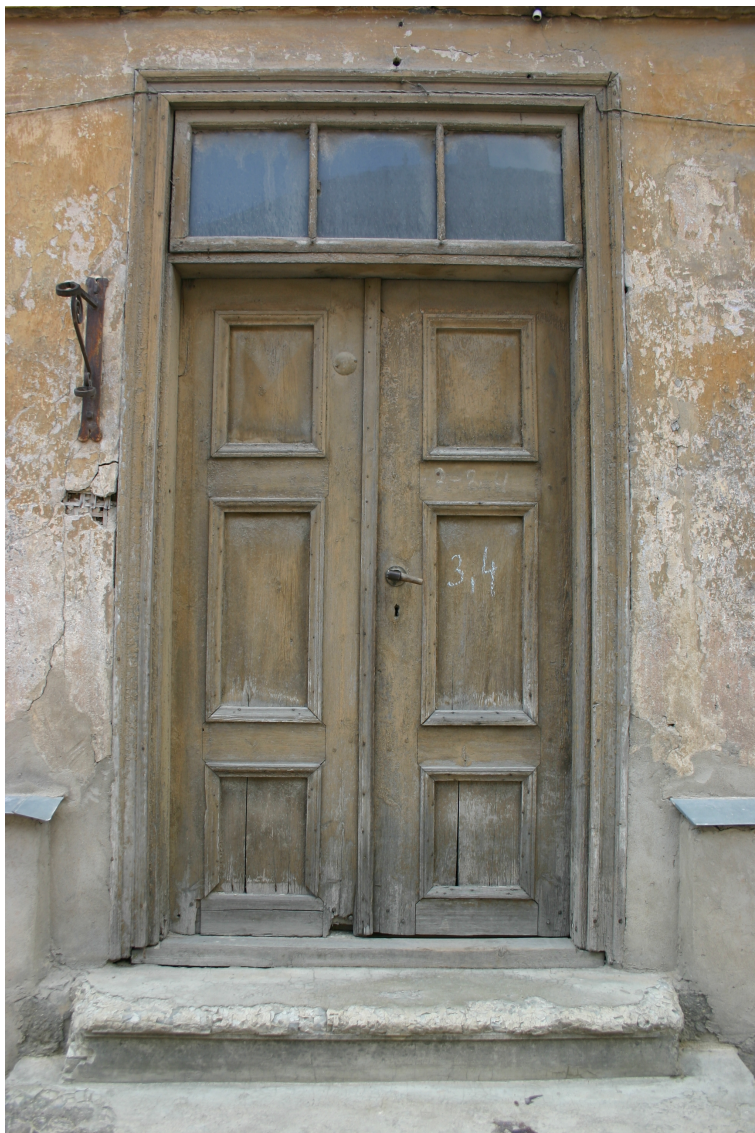
Kalna_2_62010220057001_durvis1 19.gs.3.cet. durvju komplekts ar oriģinālo aprīkojumu. Virslogam zuduši spraišļi.
