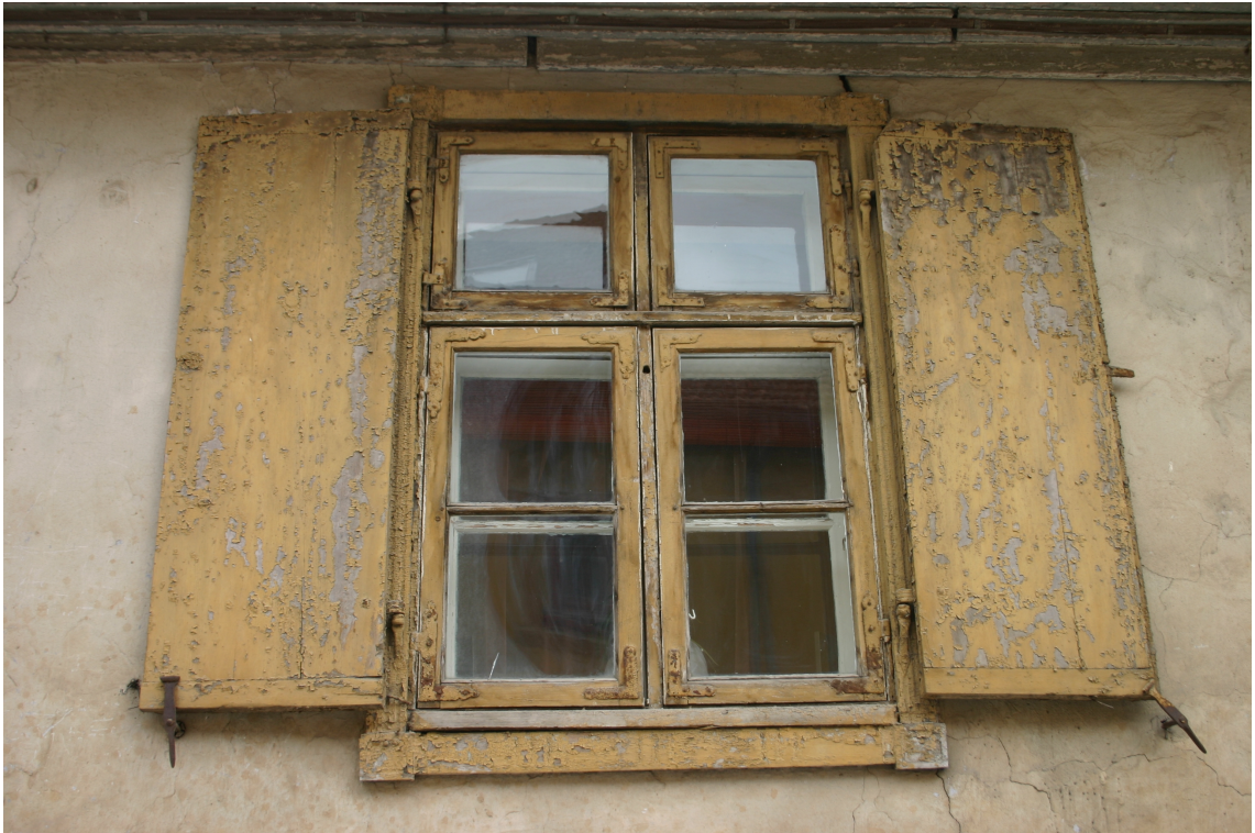
Kalna_13_62010220072001_logs1 Sākotnējs (1813.-1829.g.) logs un slēgi ar sākotnēju un vēsturisku aprīkojumu. Logam sākotnējās apmales, vērtnes mainītas.
