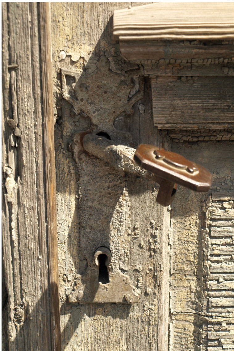
Jelgavas_16_62010220060001_durvis2 19.gs.1.cet. durvju aprīkojums.
