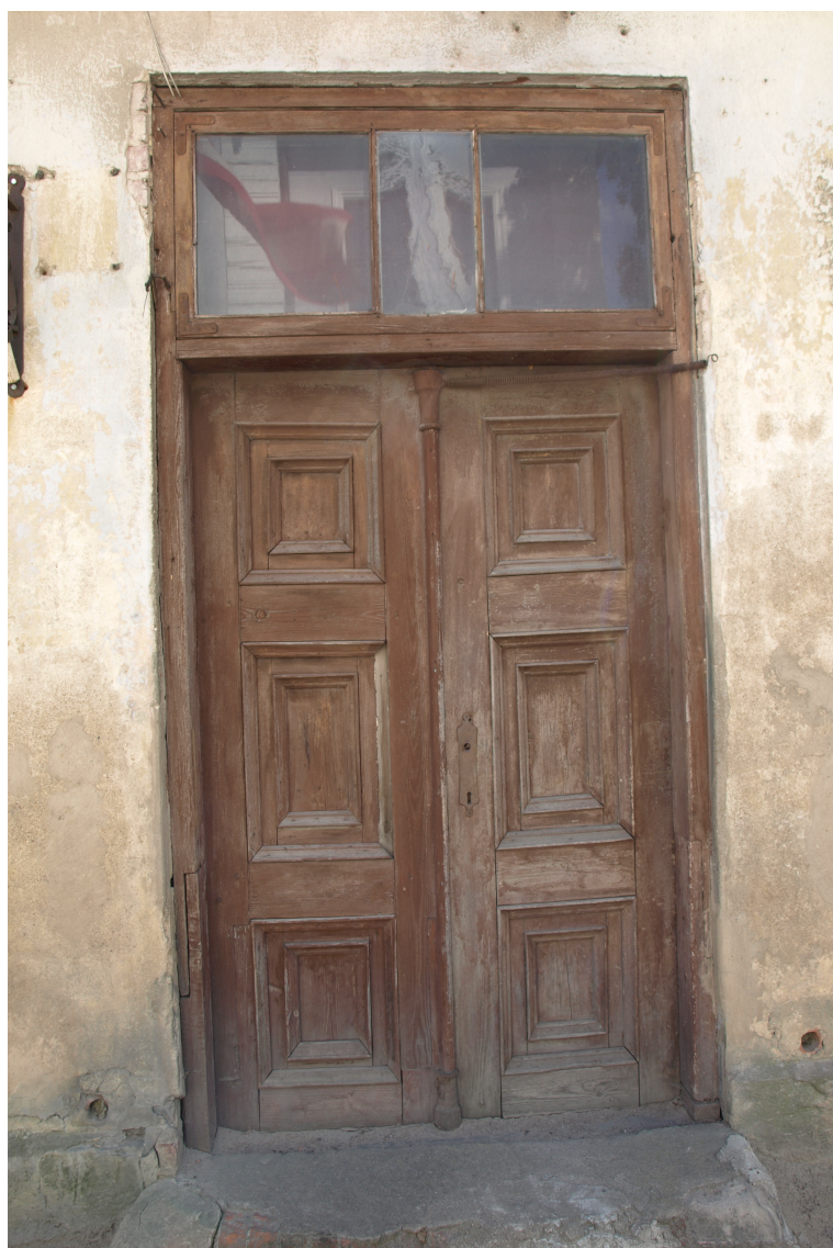
Dzirnavu_8_62010230038001_durvis1 Sākotnējo (1870to gadu sāk.-1879.g.) durvju komplekts ar daļēji saglabājušos oriģinālo aprīkojumu.
