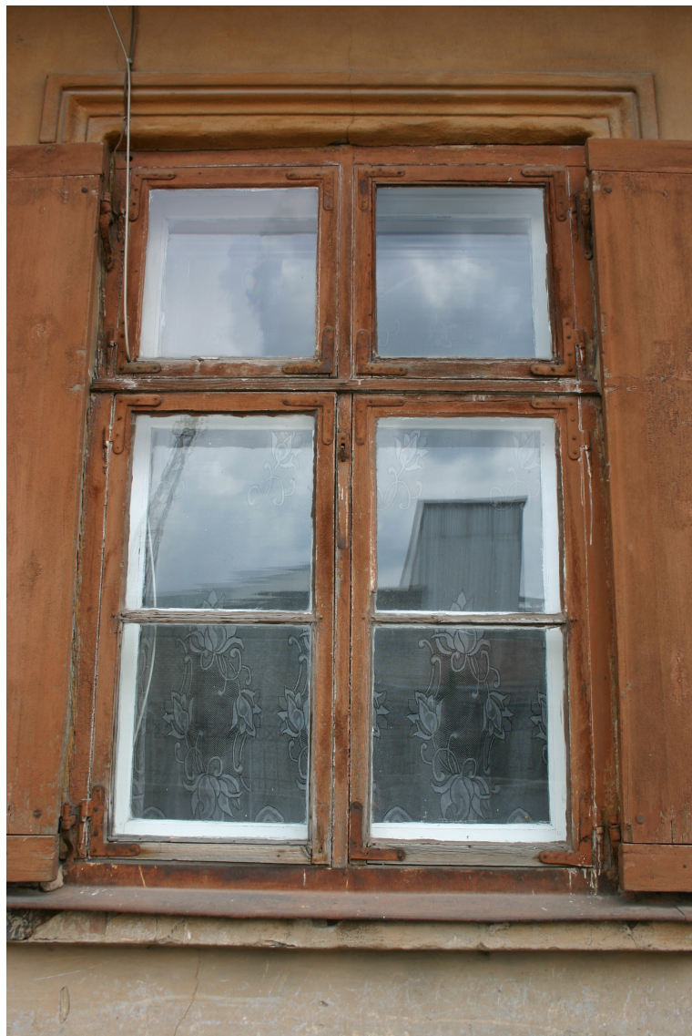
Dzirnavu_6_62010230054001_logs1 Sākotnējais (19.gs.3.cet.) logs ar oriģinālo aprīkojumu.
