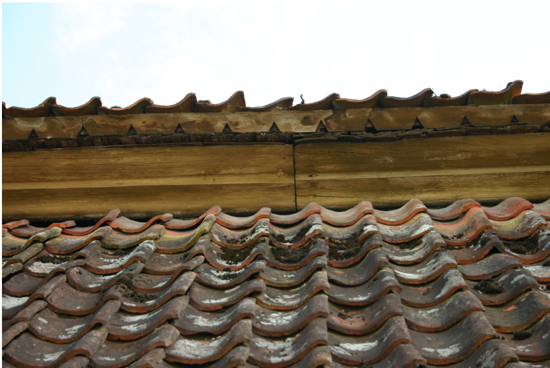
Bazniicas_36_62010220045001_dzega1 Sākotnēja (1807.g.) koka dzega un 20.gs.2.puses kokā griezts aizsegdēlis.
