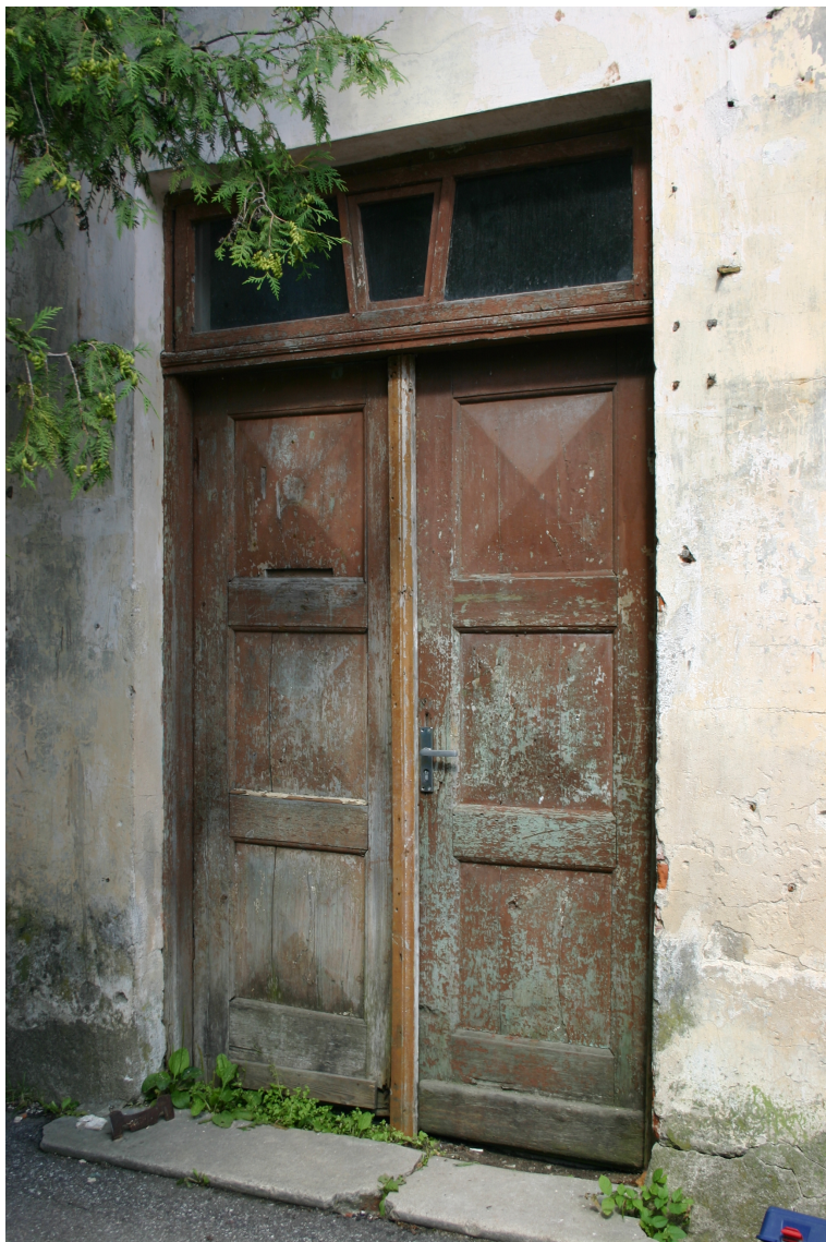
Baznīcas_34_62010060074001_durvis1 19.gs.3.cet. durvju komplekts (virslagam zudušas šproses).
