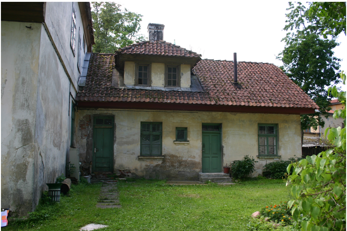
Bazniicas_34_62010060074001_fasade4 Skats uz 20.gs.1.cet. (pēc 1913.g.) piebūves ziemeļaustrumu fasādi. Piebūvei oriģinālā jumta izbūve.
