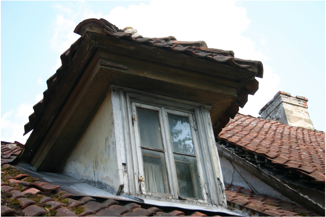
Baznīcas_34_62010060074001_fragment1 20.gs.1.cet. (pēc 1913.g.) jumta izbūve ar oriģinālo logu un tā aprīkojumu.
