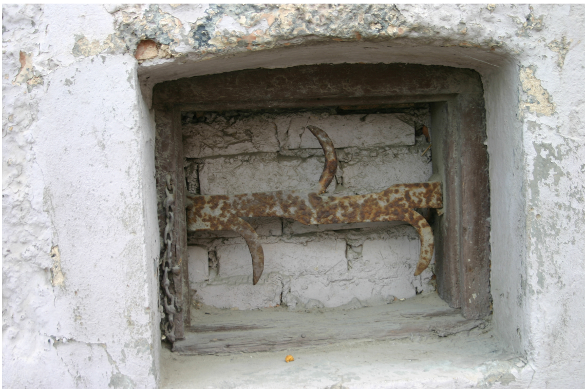
Bazniicas_6_62010230014001_logs4 19.gs.3.cet. loga aploda un metāla restes.
