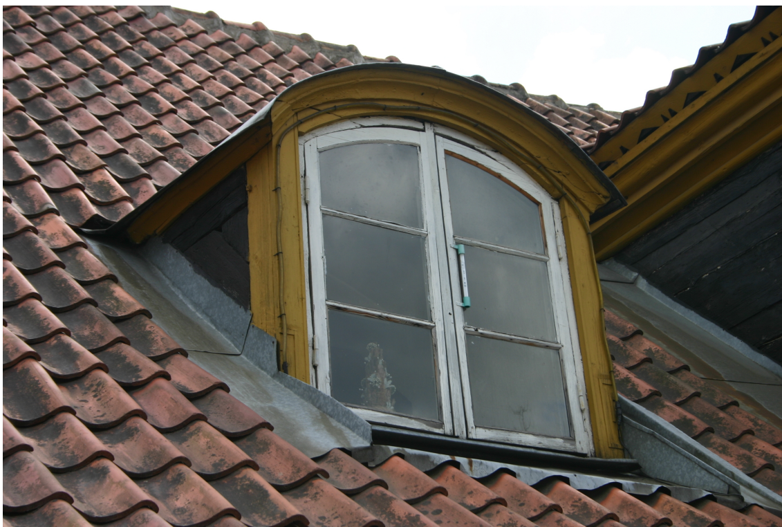
Bazniicas_5_62010060102001_fragments2 Sākotnējā (19.gs.1.cet., līdz 1813.g.) jumta izbūve. Daļēji zuduši priekšējie dekoratīvie dēļi.
