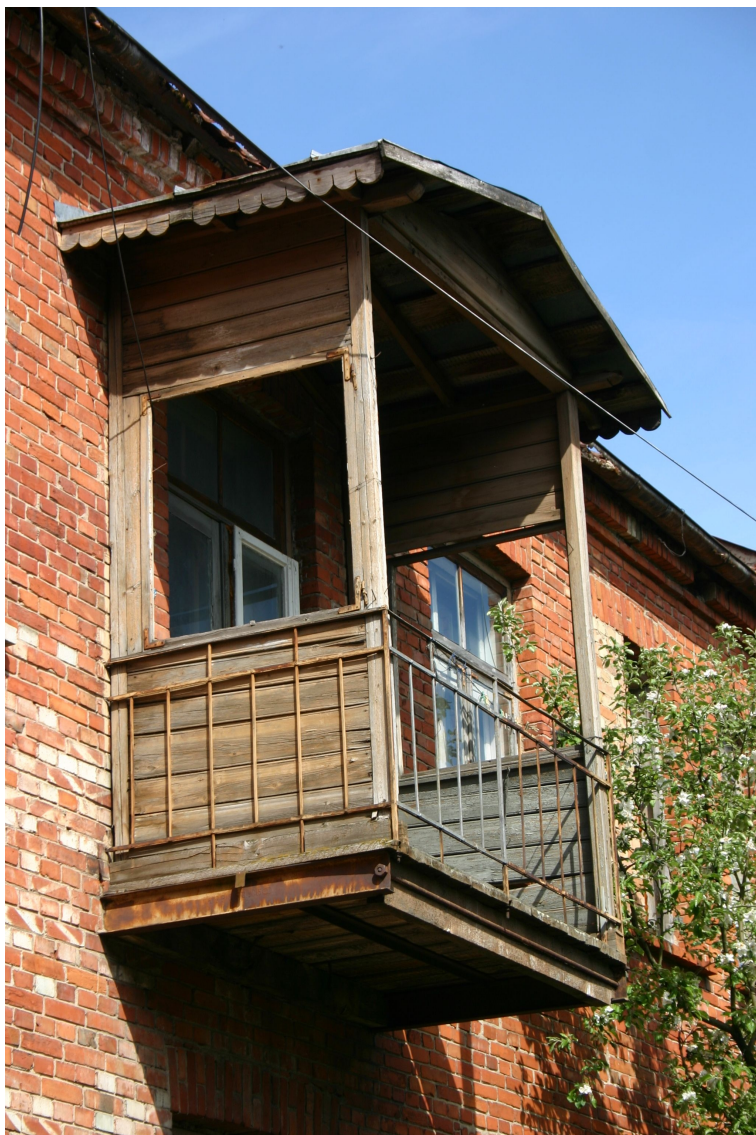
Bazniicas_11a_62010060078001_fragments1 Sākotnējs (20.gs.20.gadu) daļēji slēgts balkons. Sānu plaknēs esošajiem logiem zudušas šproses.
