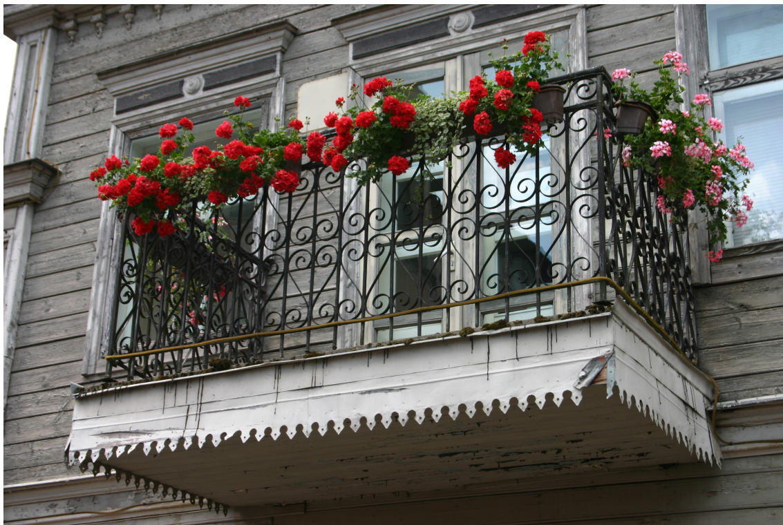
1905_gada_1_62010060039001_balkons1 Vēsturiskas balkona margas, pamatne – 20.gs.2.puse.
