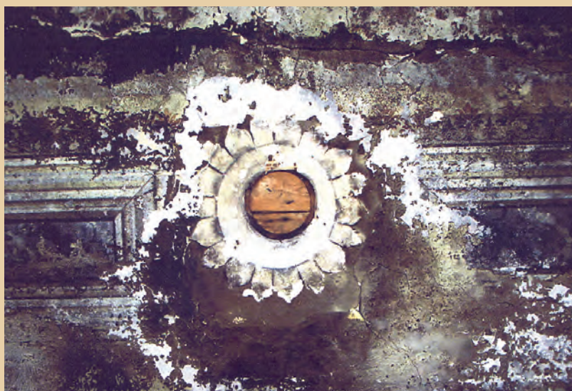
245. Lūgšanu nama sienu dekoratīvais krāsojums pirms atjaunošanas (VKPAI PDC, lieta Kuldīgas sinagoga )
