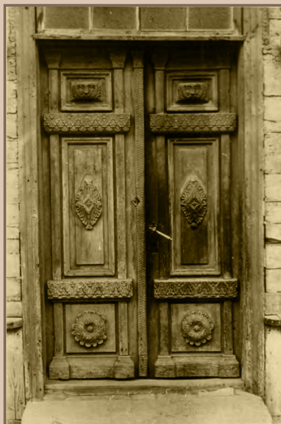
302. Ārdurvis Liepājas ielā 17. 19. gs. otrais ceturksnis (VKPAI PDC) Street door at Liepājas iela 17. Second quarter of the 19th century (SIHP MDC)
