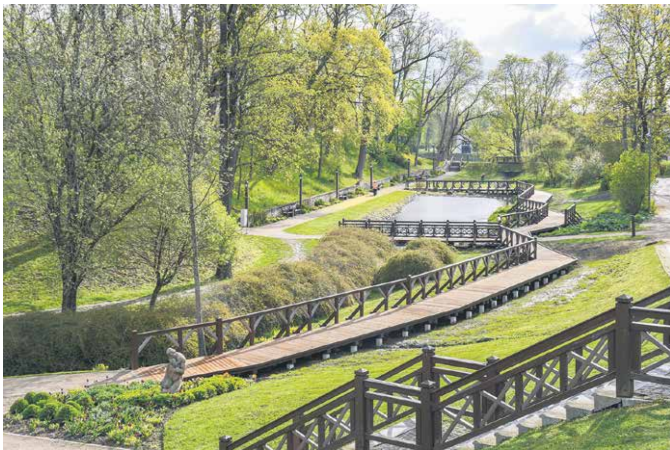
Noslēgsies gājēju laipu atjaunošana Pilsētas dārzā un skvērā pie “Kūravas”. Iepriekšējās laipas bija savu laiku nokalpojušas. Lai tās ilgāk kalpotu, izbūvēts betona pamatu risinājums.
