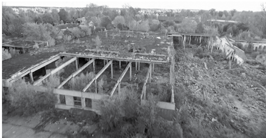
Bijušā "Vulkāna" teritorijā ir vidi degradējoša un bīstama, tāpēc Domes deputāti lēma – ja teritorijas būvju īpašnieks bīstamās ēkas nenovērš, to darīs pašvaldība, izdevumus piedzēnot no īpašnieka.
