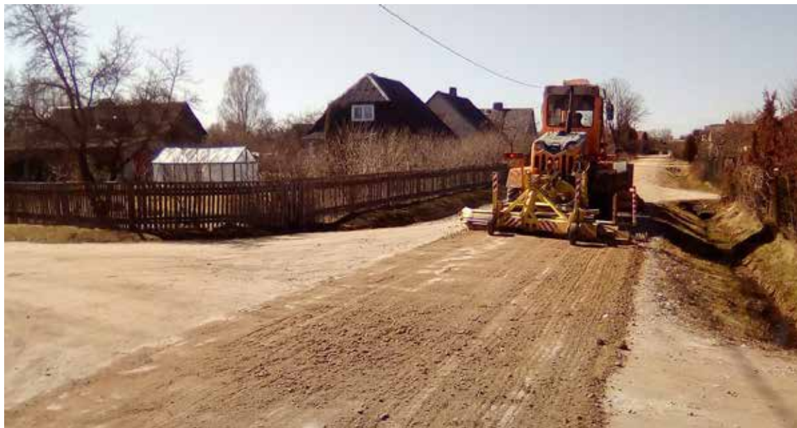
SIA "Kuldīgas komunālie pakalpojumi" uztur kārtībā pilsētas ielas, ceļus un laukumus, kuru kopgarums ir ~79 kilometri. Visvairāk ir grants un melnā seguma ceļi, pēc tam – betona un akmens bruģa.
